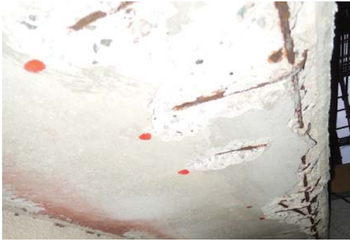
スラブ裏（軒天）の爆裂が顕著に見られた。地面からの湿気を多く受けたことが原因と考えられるため、補修後、吹付タイルで仕上げることで吸水しないよう対処する予定。
