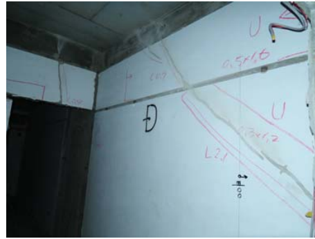
劣化部分はすべてマーキングを行い、全数量の統計を取った。前施工不備によるジャンカや、揺れあるいは収縮によるひび割れも多数見られた。
